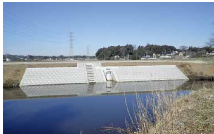
工事名：26国補河川総流防 第26-05-942-0-015号 排水樋管工事 発注者：土浦土木事務所 完成日：H28.3.1
