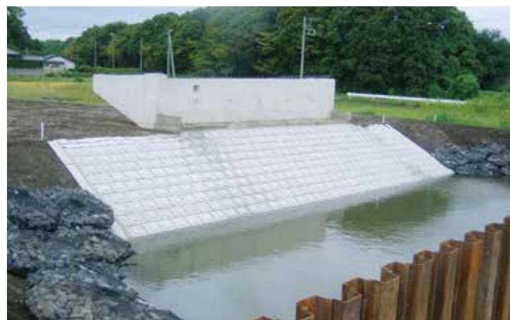
工事名：24国補地道 第24-03-287-0-002号 24国補河川総流防 第24-05-367-0-022号 合併 橋梁下部工事(谷中橋) 発注者：土浦土木事務所 完成日：H25.10.4
