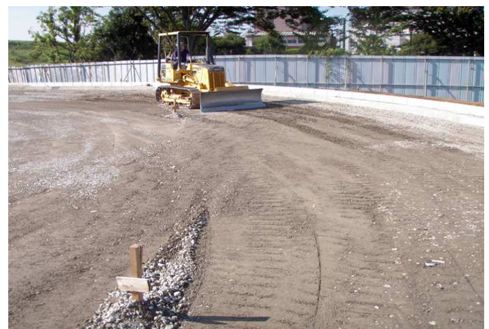
• 平成20年(2008年) 樋野口取水場関連樋管撤去工事に伴う迂回道路築造工事
