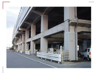
東北新幹線 耐震補強 施工場所：那須塩原市 発注者：鉄建建設(株) 竣工年：2008年
