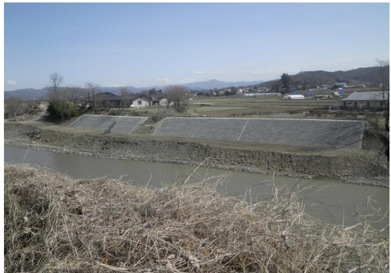
1災公共土木施設災害復旧工事 (一)千曲川 佐久市 結の里千曲裏他(JV) 護岸ブロック工事
