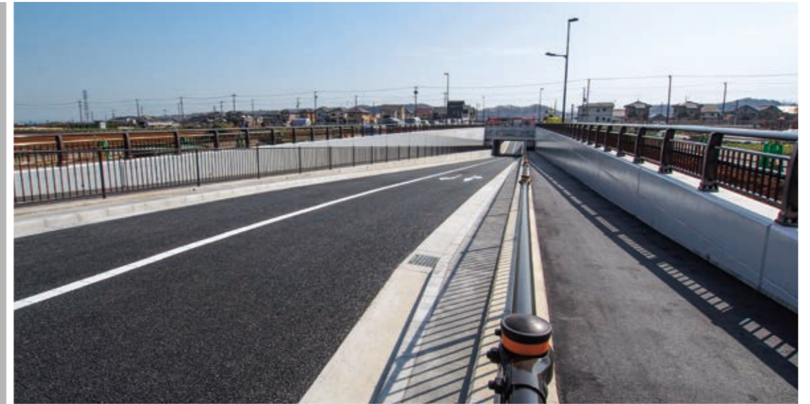
あきる野市道路改修工事のうち擁壁設置工事 (西-雨間立体の4) (東京都発注)
