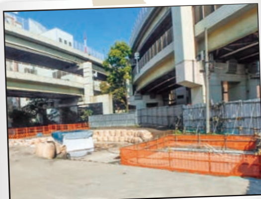
古川地下調節池工事 (その3-2) 平成 27 年度東京都建設局優良工事表彰受賞
