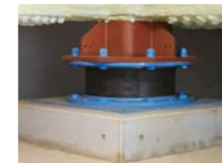
免震構造(石川建設本社ビル)
