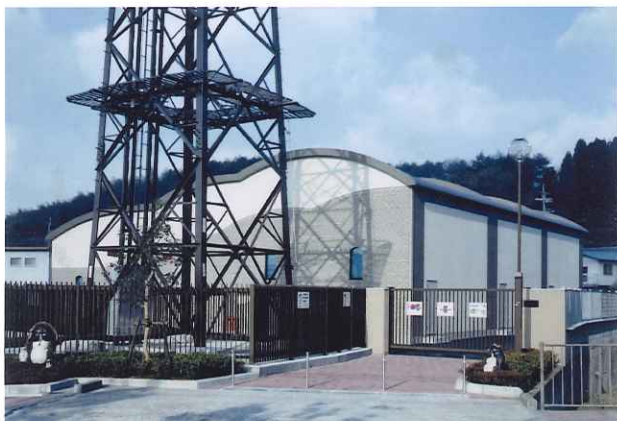
関西電力㈱信楽変電所（滋賀県信楽町）
