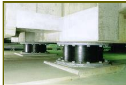
■写真-⑨:免震装置
