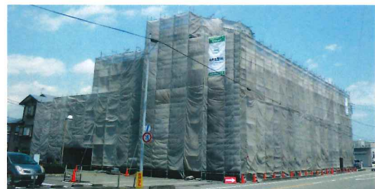
ビルリフォームメンテナンス工事(内装及び外壁改修工事)
