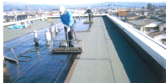
社員寮屋上防水改修工事 ノンケトル冷熱工法(BANKS工法)
