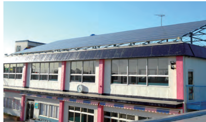
▲太陽光発電（ソーラーパネル）設置事例
