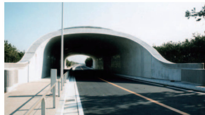
国道134号線 湘南の森トンネル(上り線) トンネル・橋・道路 規模:400m
