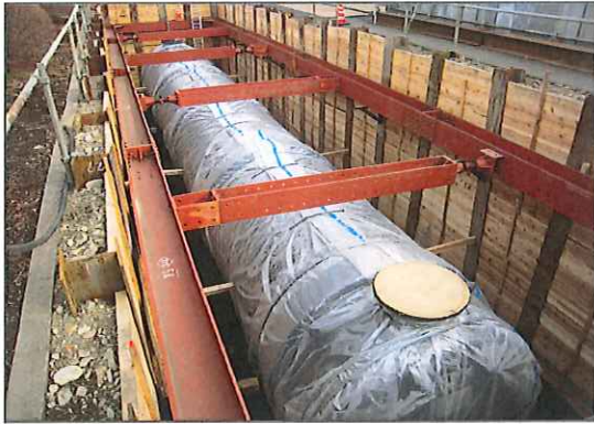
19年度 飲料水兼用耐震性貯水槽整備工事
