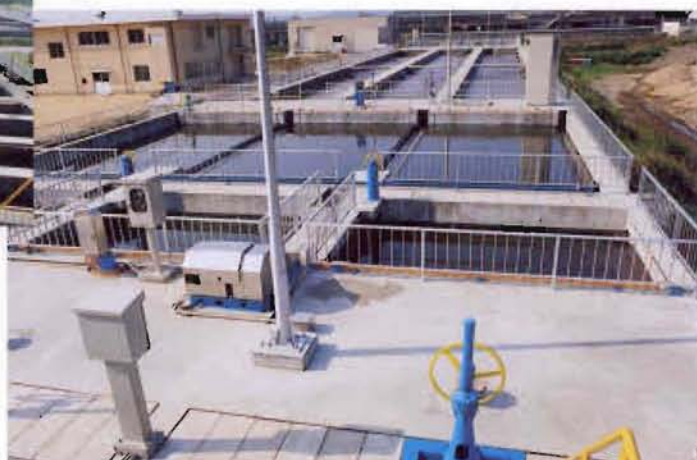
施主／宇部市役所 工事名／西部処理場建設工事 ●場所／山口県宇部市
