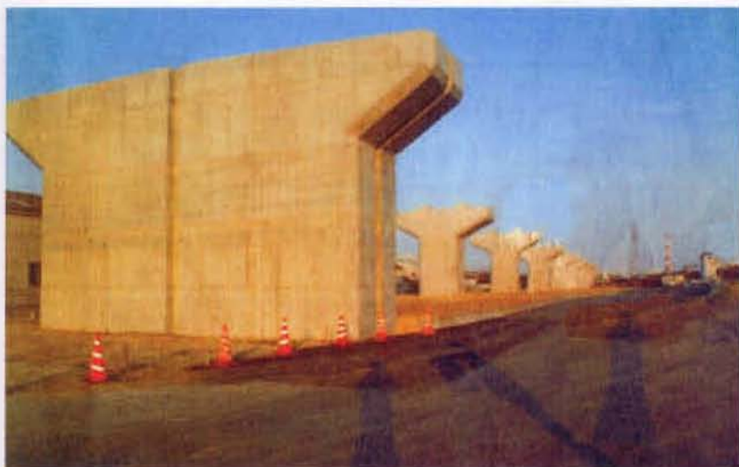
施主/山口県 工事名/宇部湾岸厚南高架橋橋梁整備工事(JV) ●場所/山口県宇部市
