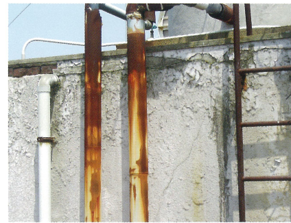
外壁及び設備配管劣化状況
