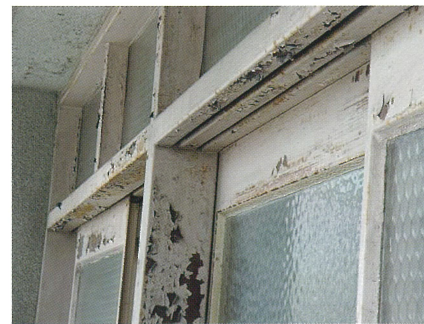
外部鉄部の劣化状況
