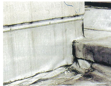
屋上シート防水劣化状況
